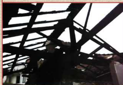
Acima: Julinho, Mestre Luís e o telhado do prédio do IPDH após o incêndio.
