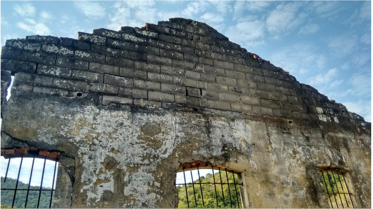
Apêndice 12: Ruínas sem telhado (2016)
