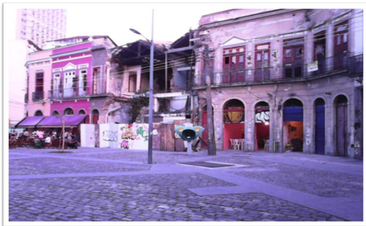
Figura 13: Imóvel situado no Quilombo Pedra do Sal (foto tirada por Vania Oliveira Ventura, em 10/09/2014).
