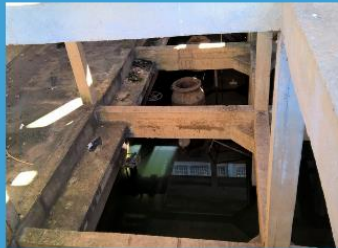
Bombas de água
