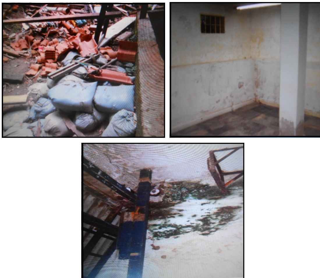
Imagem 7: Telhado da reserva técnica do MIAN após forte período de chuvas Foto: Museu Internacional de Arte Naïf do Brasil
