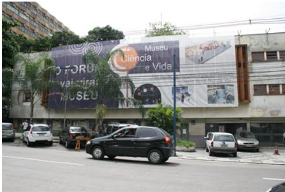
Imagem 8 : Início das obras no prédio do Fórum em 2008 para se transformar no Museu Ciência e Vida. (Fonte: Arquivos do Museu Ciência e Vida)
