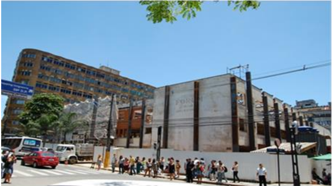
Imagem 7: Início do processo de demolição no prédio do Fórum em 2008 para a adaptação ao Museu Ciência e Vida.
