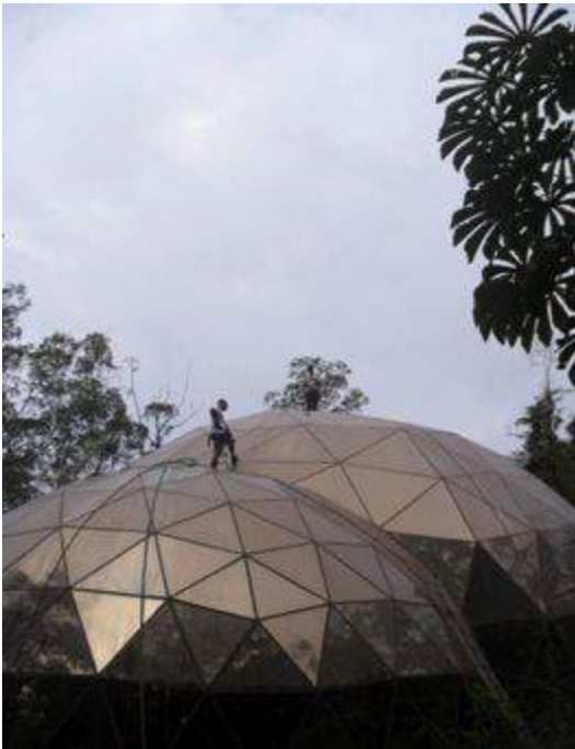
Figura 25_ Da Lama Lâmina , Matthew Berney, 2004- 2009. Limpeza externa da estrutura da obra, pela equipe de manutenção.
