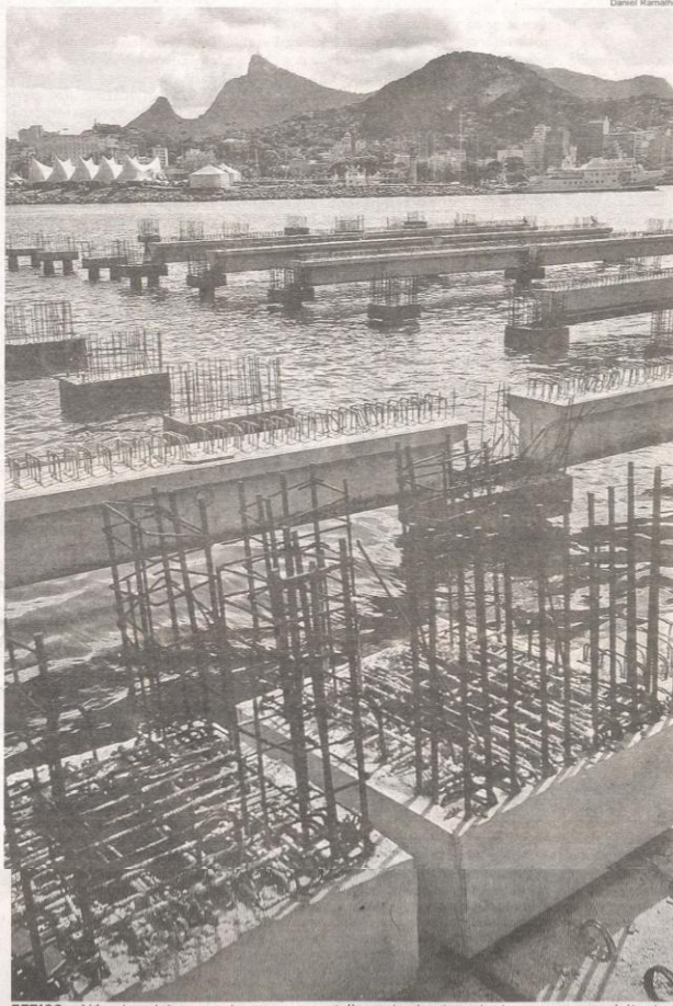
PERIGO — Além de poluir a paisagem, os vergalhões da obra inacabada ameaçam os visitantes
