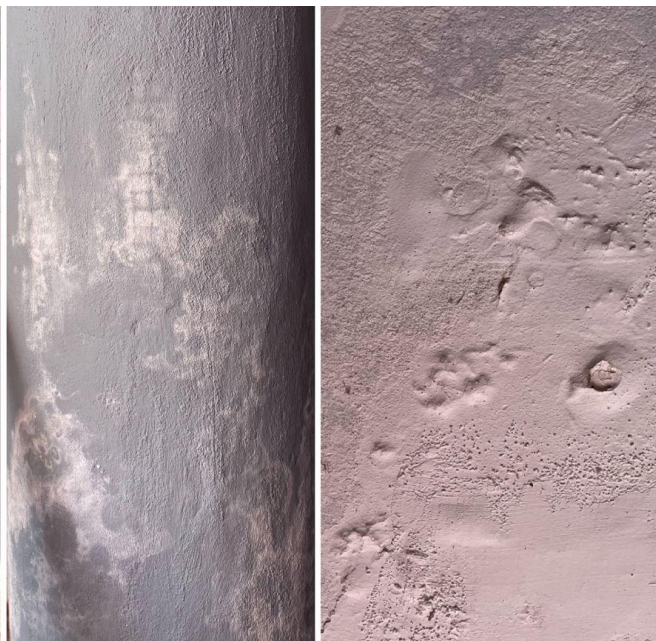
Figura 44 e 45: Umidade no interior da casa.
