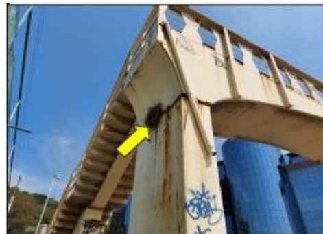
Figura 4 - Obra 25 - Passarela Mourisco (Botafogo): Vista de um dos apoios da passarela Mourisco com sinais de corrosão e presença de vegetação.
