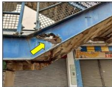
Figura 14 - Obra 123 - Passarela sobre a Av. Oswaldo Aranha e Rua Teixeira Soares (Posto INSS): Detalhe do grau de corrosão da viga de sustentação da estrutura metálica das escadarias de acesso.
