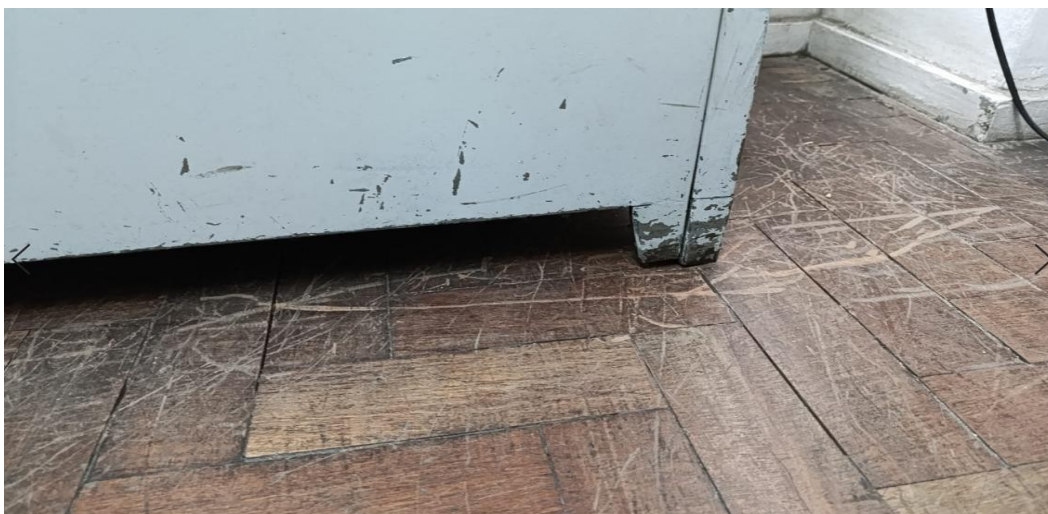
Figura 43– Piso inadequado em madeira.
