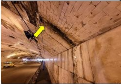
Figura 7 - Obra 45 – Túnel Prefeito Sá Freire Alvim: Infiltração em estágio avançado na lateral direita da abóboda do Túnel
