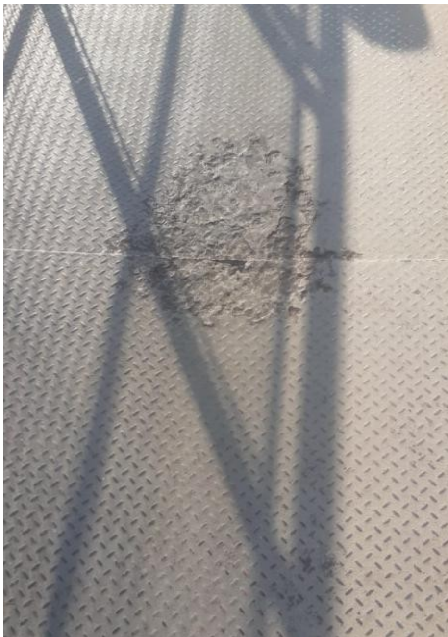
Figura 89 - Passarela da Estação Leopoldina - meses após a reforma (deformação no piso)
