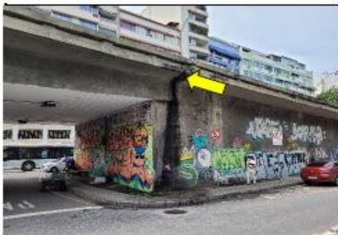
Figura 3 - Obra 20 - Viaduto Engº Noronha (Laranjeiras): Vista lateral do viaduto com detalhe da infiltração oriunda do tabuleiro
