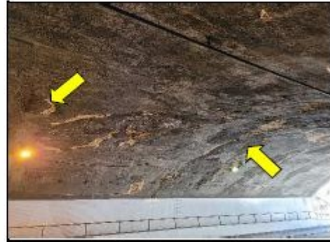
Figura 8 - Obra 46 – Túnel Major Vaz: Segregação do revestimento da abóboda e presença de infiltração
