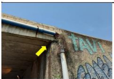
Figura 1 - Obra 01 – Viaduto Trevo dos Estudantes: Drenagem danificada
