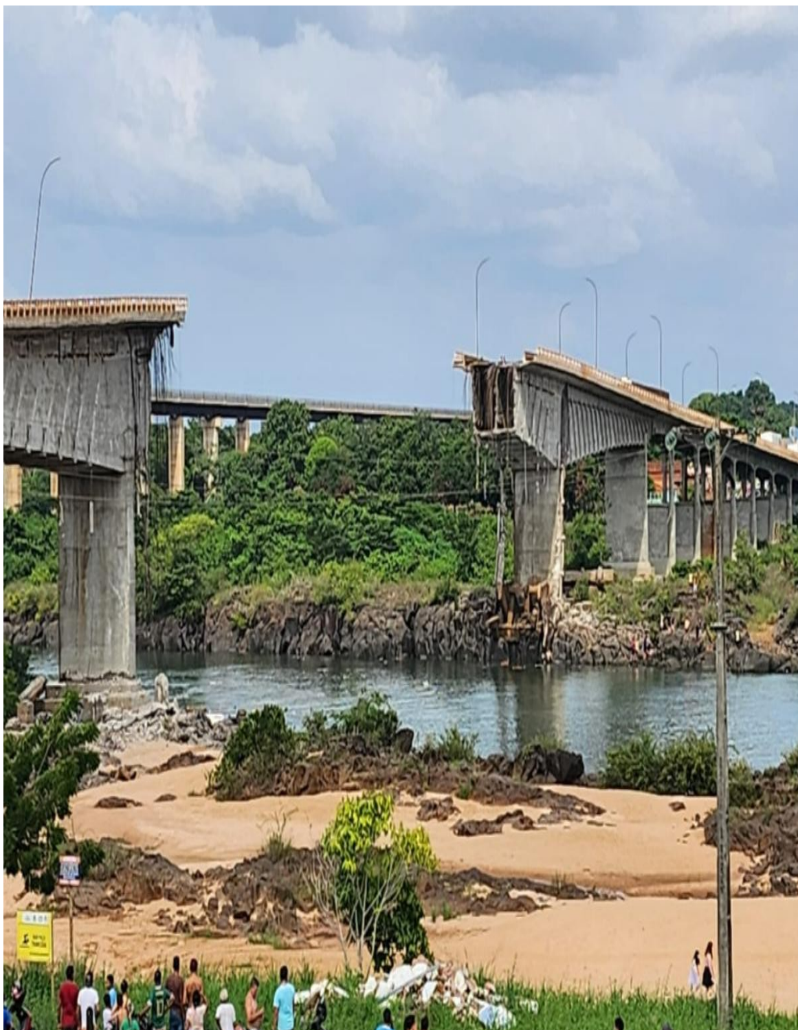
Figura 7 - Vista da Ponte Juscelino Kubitschek de Oliveira após seu desabamento, em 2024.
