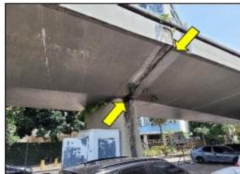
Figura 6 - Obra 29 - Viaduto Santiago Dantas (Botafogo): Infiltração oriunda da junta de dilatação do tabuleiro sobre pilar, com crescimento de vegetação
