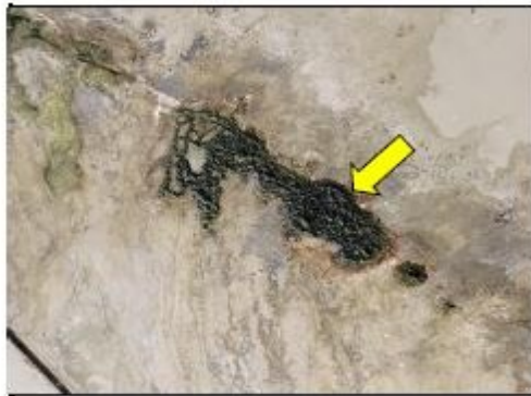
Figura 11 - Obra 83 – Viaduto Augusto Schmidt (Lagoa): Infiltração em estágio avançado na face inferior do viaduto
