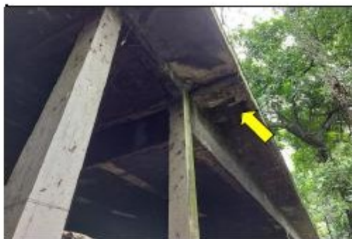
Figura 15 - Obra 183 - Viaduto Santos Dias (Av. Edson Bastos): Detalhe do elevado grau de deterioração da junta de dilatação e também da laje do tabuleiro.
