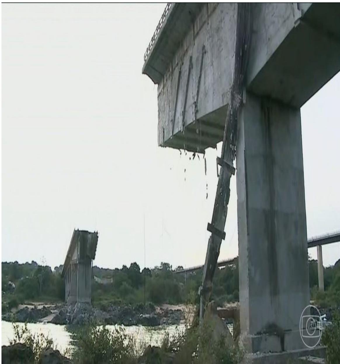
Figura 8 – Pilares da ponte Juscelino Kubitschek após o seu desabamento.
