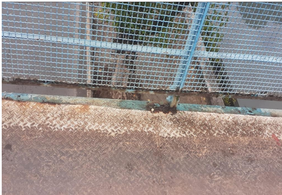
Figura 84 – Passarela Estação Leopoldina (piso e guarda corpo corroídos)
