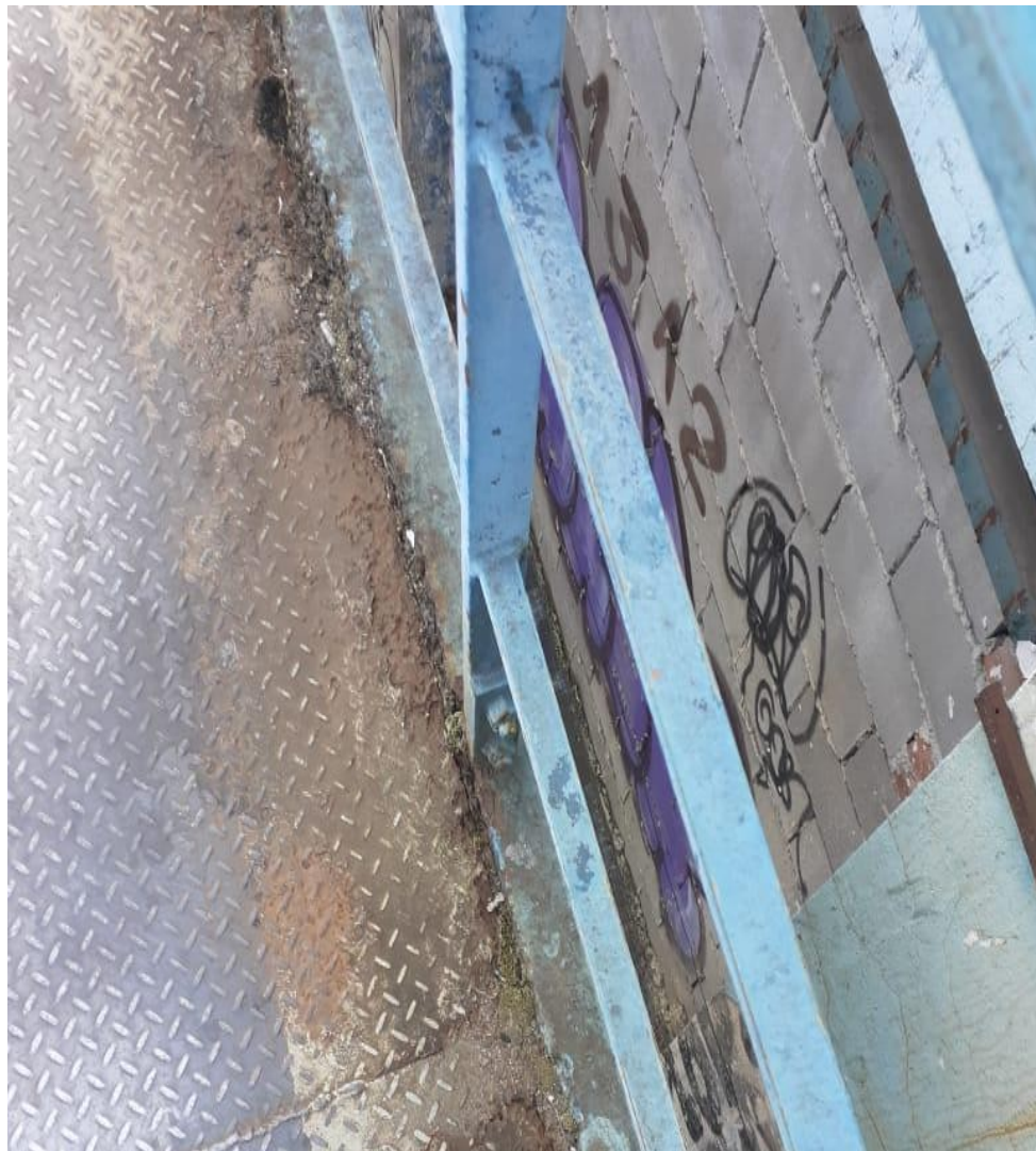
Figura 13 – Imagem do estado de conservação do piso de passarela em frente à estação de trens da Leopoldina, Rio de Janeiro-RJ.
