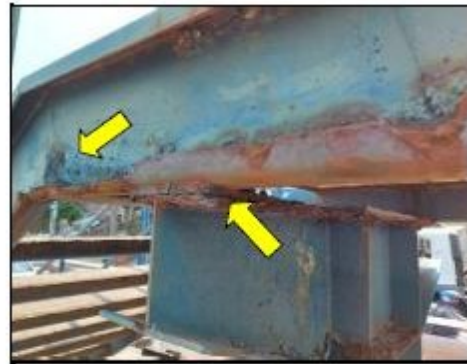
Figura 12 - Obra 101 - Passarela sobre a Av. Niemeyer (Estação da CEDAE): Detalhe de pontos de corrosão e infiltração em elementos da estrutura do patamar da passarela.
