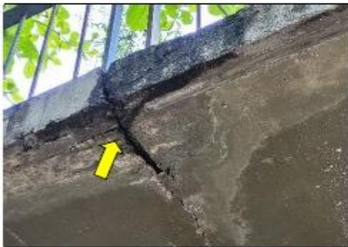
Figura 9 - Obra 66 - Passarela ao lado do Parque Catacumba (Lagoa): Detalhe de pontos de infiltração na face inferior da passarela.
