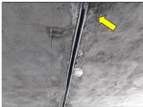
Figura 13 - Obra 117 – Viaduto Mestre Manuel: Pontos de infiltração pela junta de dilatação longitudinal.
