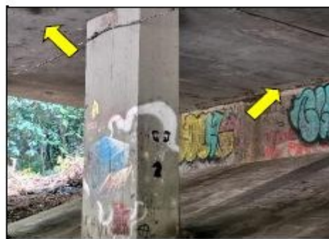
Figura 2 - Obra 19 - Viaduto José de Alencar (rua Cosme Velho): Manchas escuras na face inferior do tabuleiro do viaduto indicando presença de umidade
