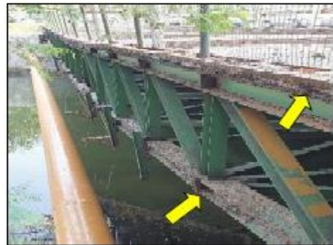
Figura 10 - Obra 68 - Passarela sobre o Canal do Jardim de Alah (Ciclovía): presença de infiltração e corrosão na estrutura
