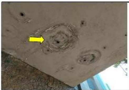
Figura 5 - Obra 28 - Viaduto Rainha Carlota Joaquina: Vista inferior do Viaduto com detalhe para pontos de infiltração no tabuleiro.
