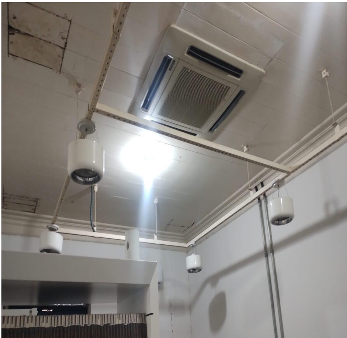
Figura 10 - Iluminação suplementar da sala do Processamento Técnico
