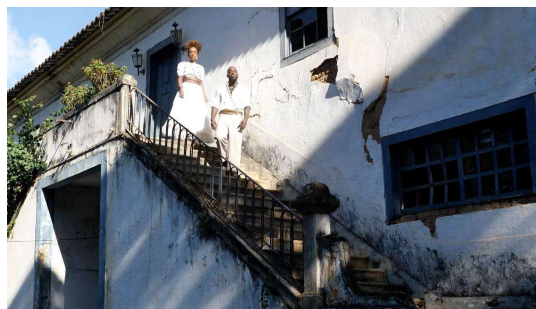
Figura 14: Fachada em ruínas, janeiro de 2021
